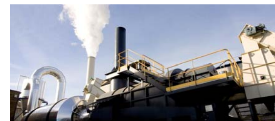
Site de production EO2
